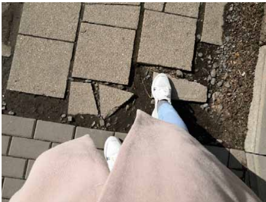
Chodník v havarijním stavu, ul. K Pasekám
